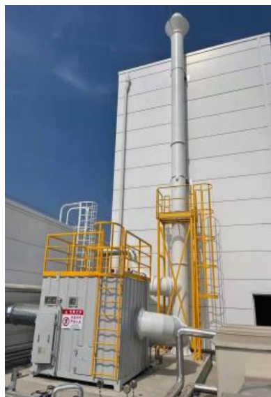
备料间和污水站排气筒 (DA003)
