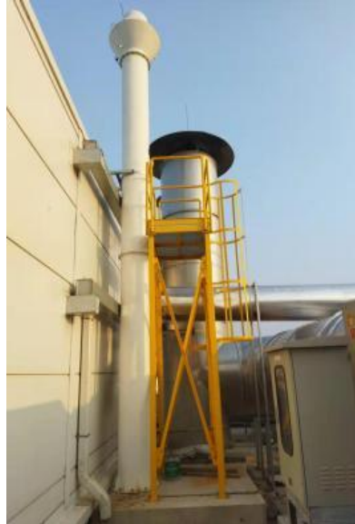
车间分散釜排气筒 (DA002)
