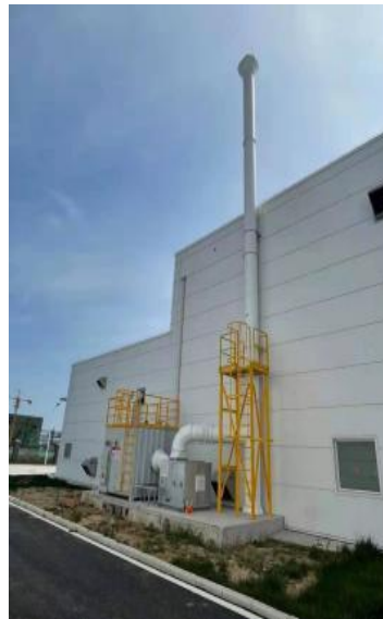
危废间排气筒 (DA004)
