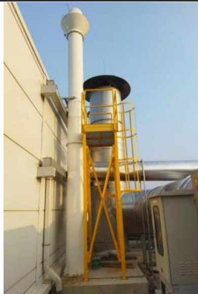
车间分散釜排气筒 (DA002)
