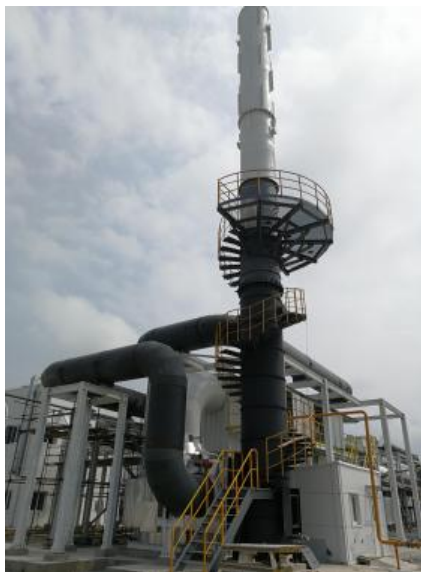
RTO 燃烧排气筒 (DA001)
